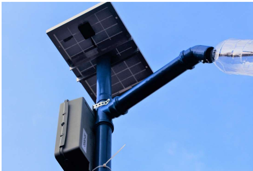
Figura 19 - Foto do poste de iluminação pública com seus componentes
