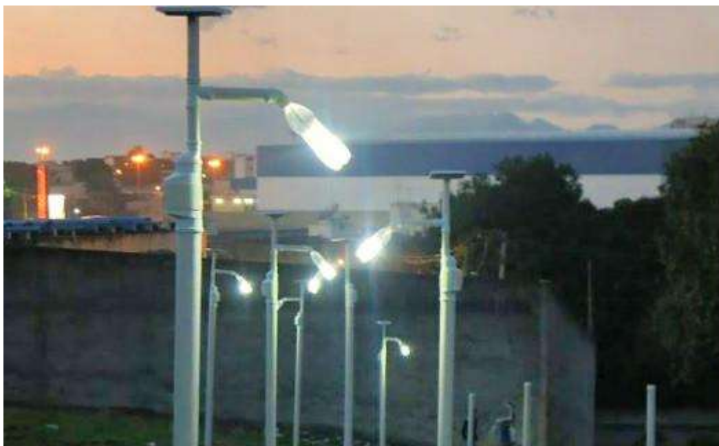
Figura 18 - Poste de iluminação pública
